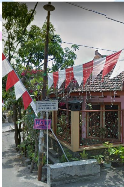
Gambar 1. Tiang listrik yang berlokasi di depan gang Blok H (Dokumentasi peneliti melalui kamera ponsel)
